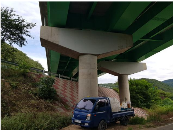
교각 P1 상태현황
