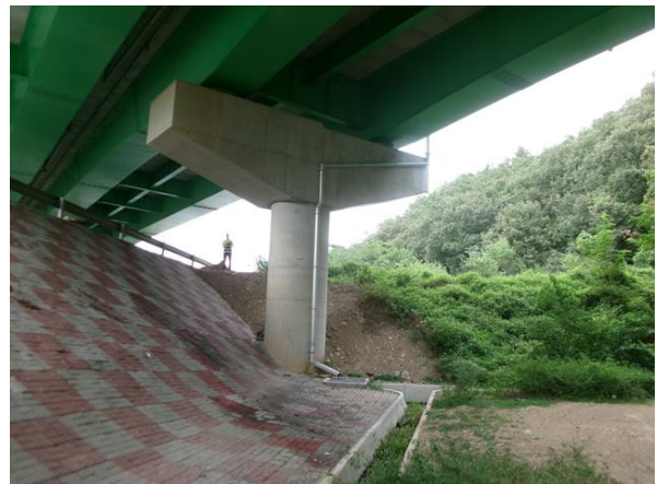
교각 P2 상태현황
